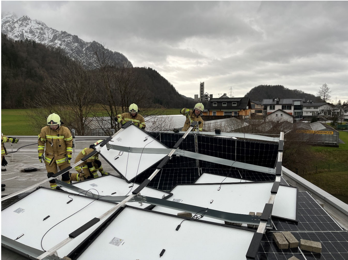
Abbildung 37: PV-Module nach einem Sturm (Josef Tschematschar - Feuerwehr Hallein)
