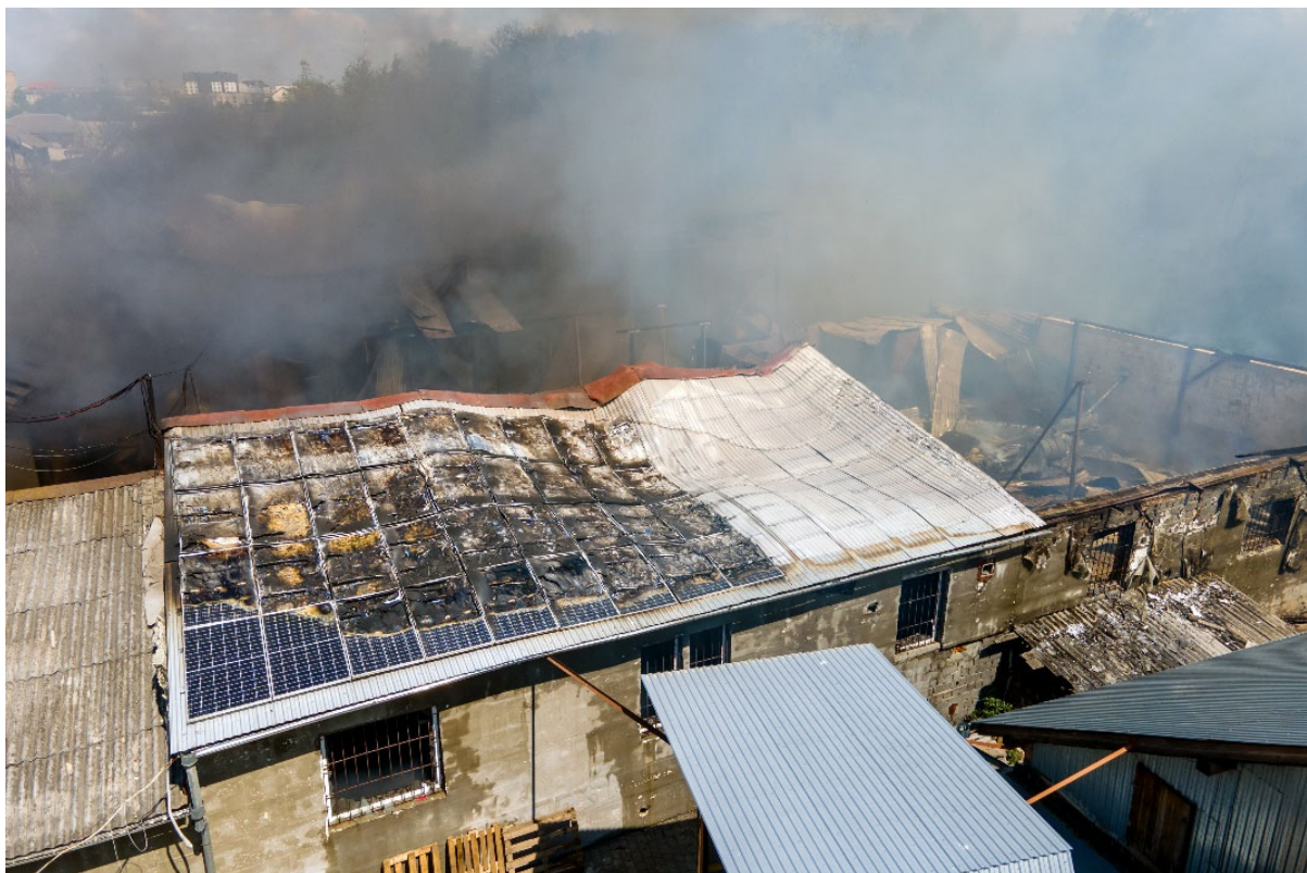
Abbildung 35: Dachstuhlbrand mit PV-Anlage (bilanol - freepik.com)
