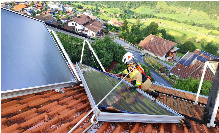
Abbildung 40: Beseitigung von Modulen im Feuerwehreinsatz (FF Wenns)
